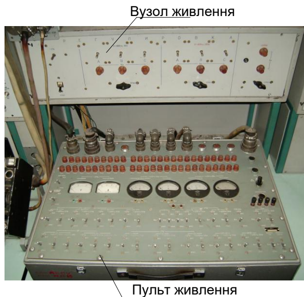
Рис. 17. Зовнішній вигляд вузла та пульта живлення (ПП-7).
